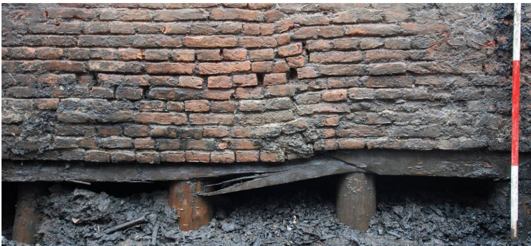
22 Deels verzakt muurwerk (S 1) van pakhuis De Koorndrager
